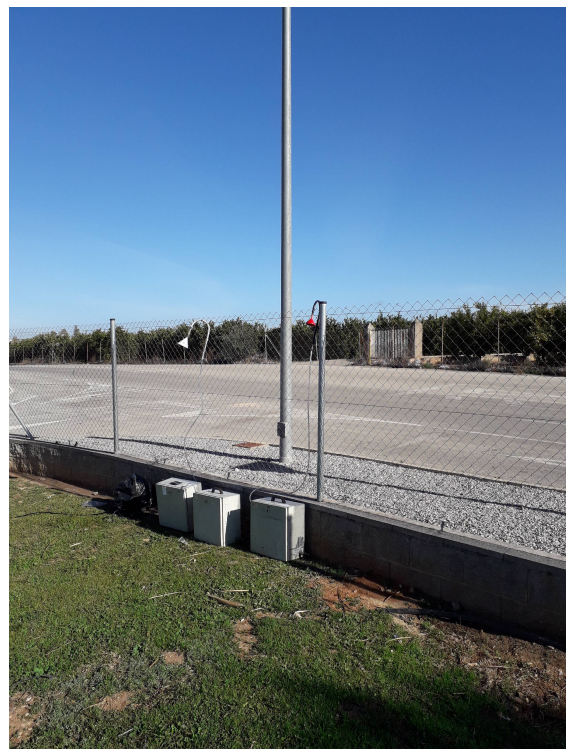
Ubicación de captadores en el Punto 4 "Rotonda junto a oficinas"
