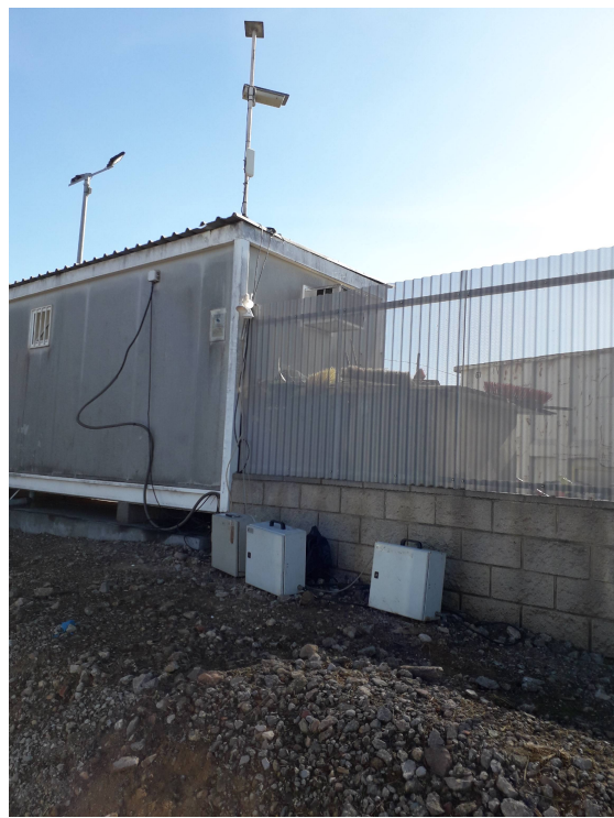
Ubicación de captadores en el Punto 3 "Biofiltro Sureste"
